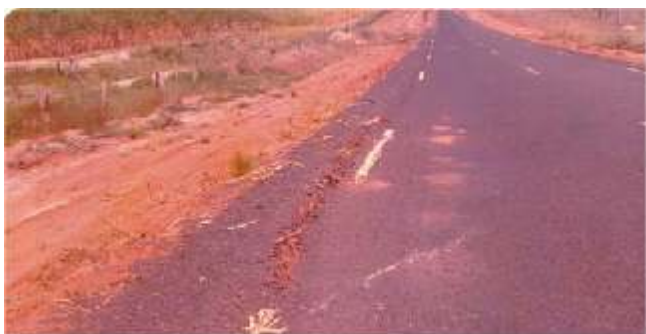
Figura 18 - Ruptura da base em borda de pavimento.
