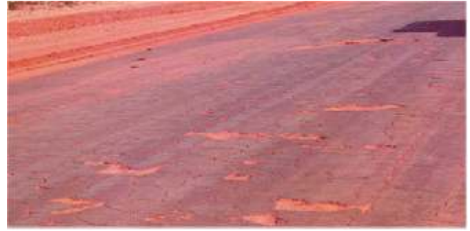
Figura 14 - Lamelas soltas pela ação do tráfego de serviço (Trecho: Cândido Rodrigues-SP).
