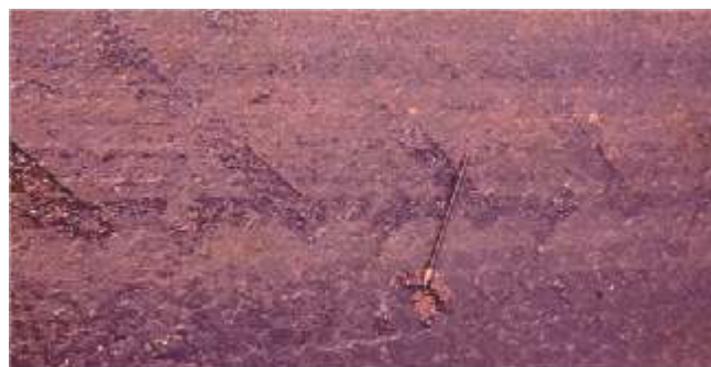
Figura 22 - Exsudação na trilha de roda por cravamento do tratamento na base.
