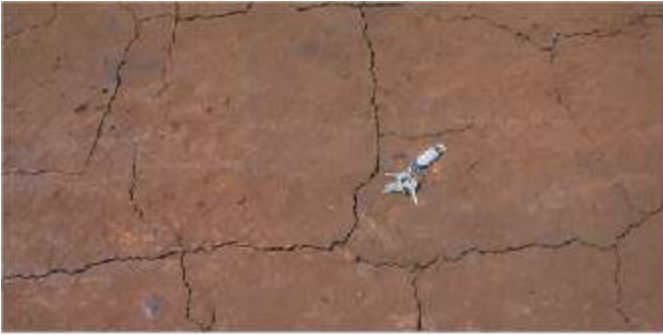
Figura 10 - Trincamento devido à secagem do SALF - solo arenoso, grupo LA'.
