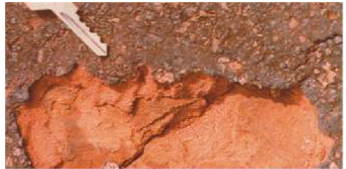
Figura 16 -Acabamento da base em "aterrinhos", causando a formação de "panelas". (Aeroporto-Araraquara).
