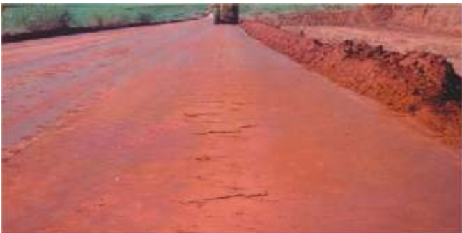
Figura 13 - Fissuramento da parte superior da base. Compactação excessiva com rolo vibratório
