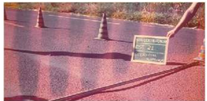
Figura 17 - Recalques longitudinais no pavimento.
