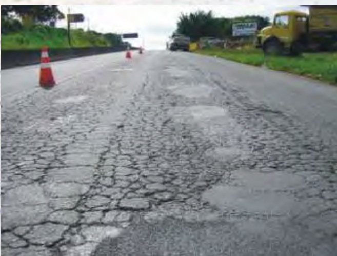
Vista da pista desagregada antes da fresagem no segmento do km 292,8 sentido Rio Bonito
