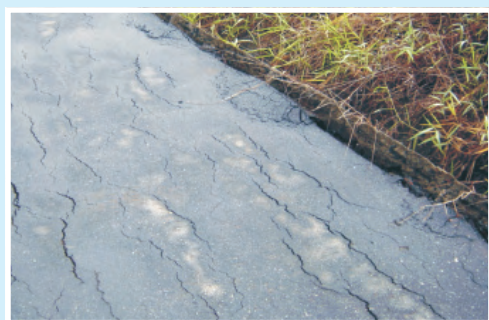
Deslocamento rotacional imposto à parede da sarjeta pela expansão das camadas de escória
