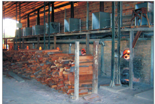
Figura 12 – Uso da lenha como combustível e instalação do novo sistema de queima.
