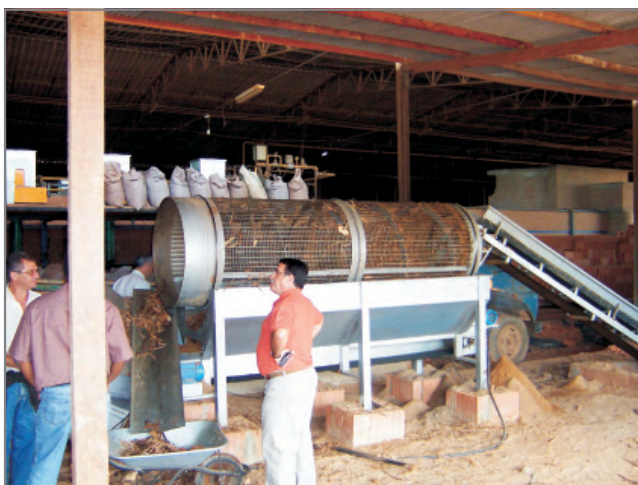
Figura 5 – Unidade de pré-tratamento da serragem.
