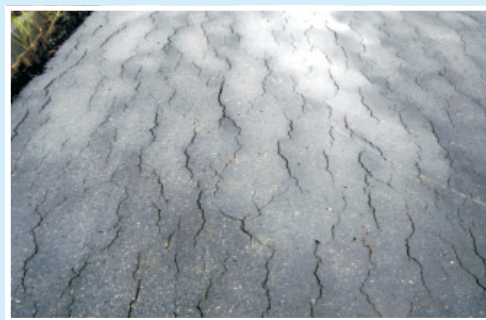
Fissuração longitudinal irregular, descontínua e generalizada
