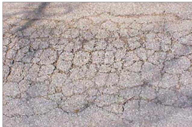
Figura 3 – Padrão de revestimento severamente trincado por fadiga.
