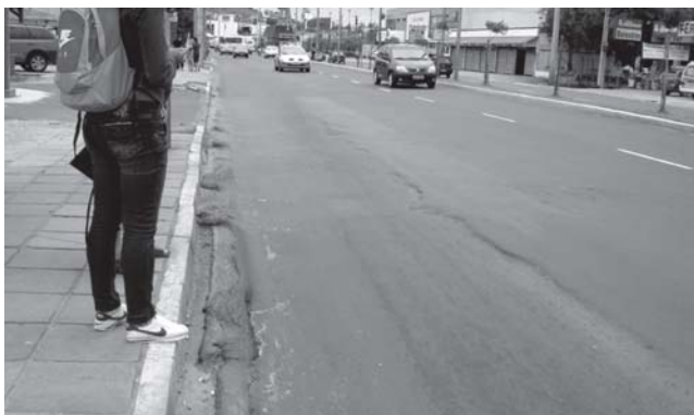
Figura 21 – Exemplo de estado atual de uma das paradas de ônibus da Av. Juca Batista em concreto asfáltico
