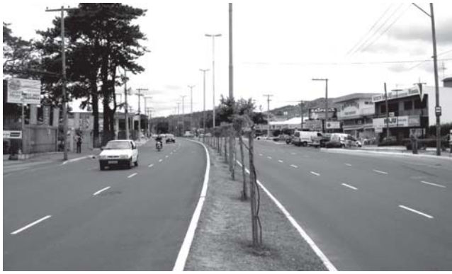
Figura 29 – Vista geral do estado atual de um trecho do pavimento asfáltico
