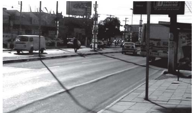
Figura 2 – Exemplo de afundamento de trilha de roda em parada de ônibus
