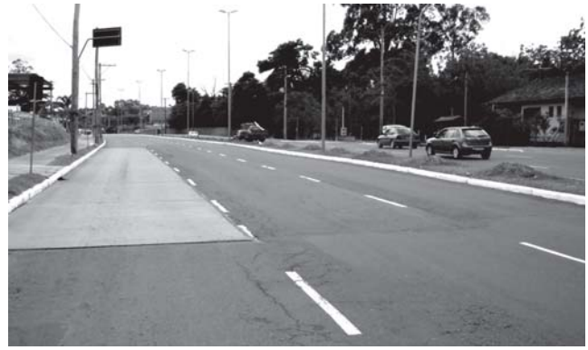
Figura 30 – Detalhe de trincas na capa asfáltica posterior à parada de ônibus
