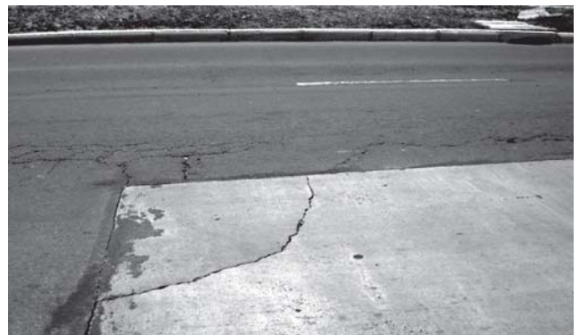
Figura 28 – Exemplo de quebra de canto ocorrente numa outra placa de concreto
