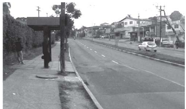
Figura 4 – Exemplo de manutenção corretiva tipo remendo em ponto de ônibus
