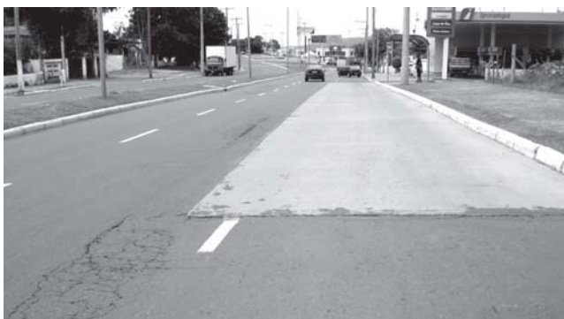
Figura 31 – Detalhe de trincas na capa asfáltica anterior à parada de ônibus
