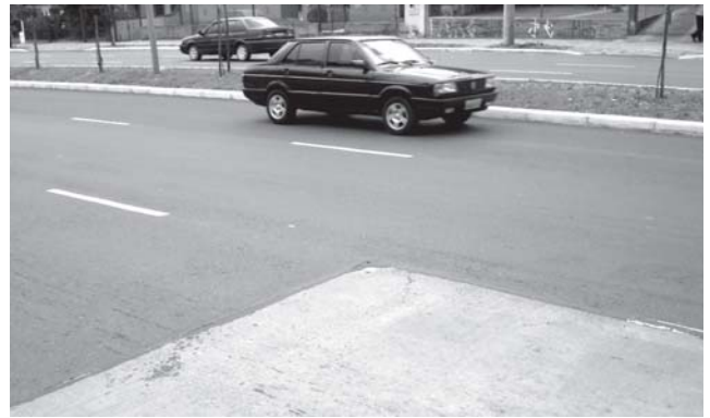
Figura 24 – Exemplo de estado atual de outra das paradas de ônibus da Av. Juca Batista em concreto cimento Portland
