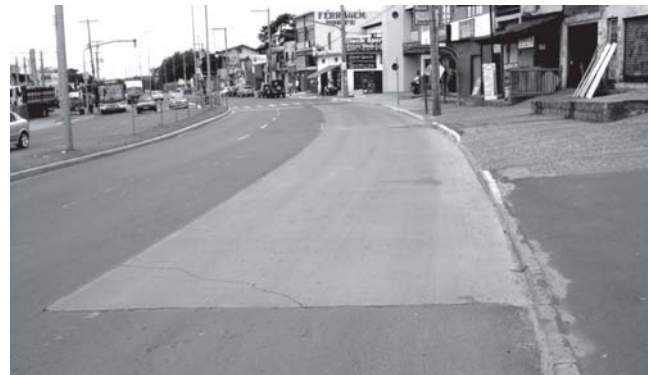
Figura 26 – Exemplo de trinca de quebra de canto ocorrente numa placa de concreto
