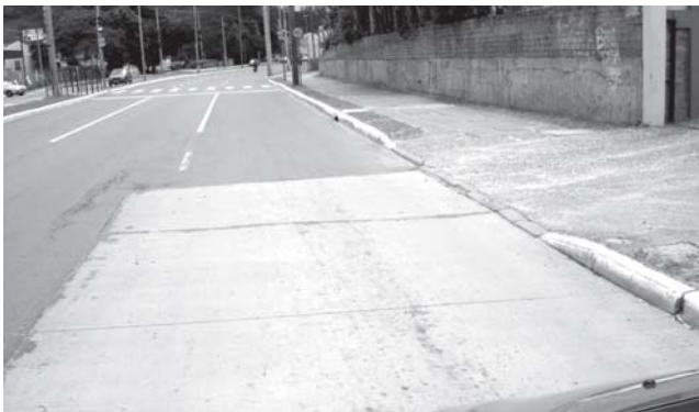
Figura 25 – Exemplo de trinca transversal ocorrente numa placa de concreto
