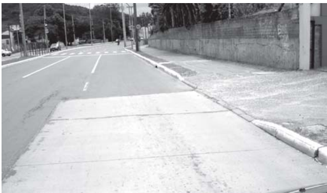
Figura 27 – Exemplo de trinca transversal ocorrente numa outra placa de concreto
