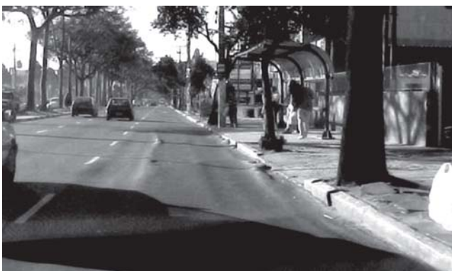
Figura 3 – Exemplo de afundamento de trilha de roda e escorregamento em parada de ônibus
