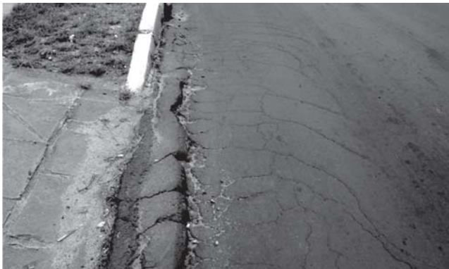
Figura 1 – Exemplo de trincas e ondulações em rua
