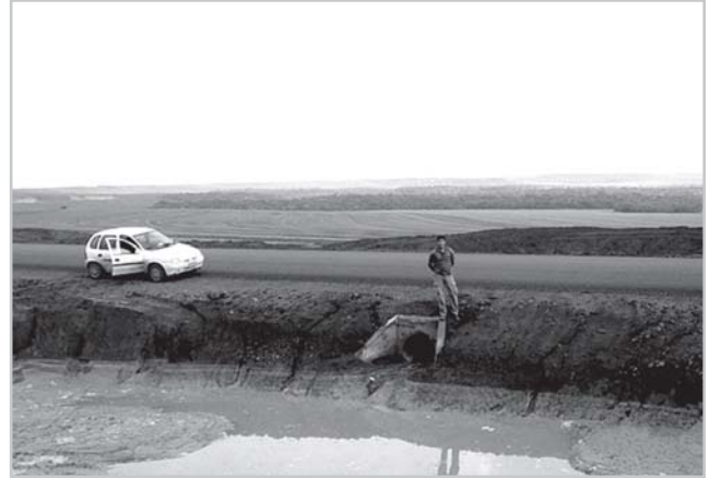
Vista de uma caixa de acumulação construída na Rodovia MT-235, subtrecho Rio Papagaio-Sapezal com a marca do nível alcançado e o poder de infiltração no lençol freático. Com detalhe do desnível do terreno no lado de jusante, sem cicatrizes de erosões.
