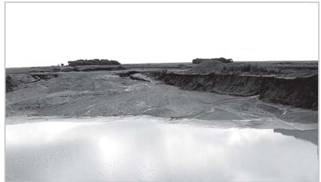
Outra vista da acumulação de águas superficiais numa caixa de empréstimo em material arenito na Rodovia MT-235, subtrecho Rio Papagaio-Sapezal.
