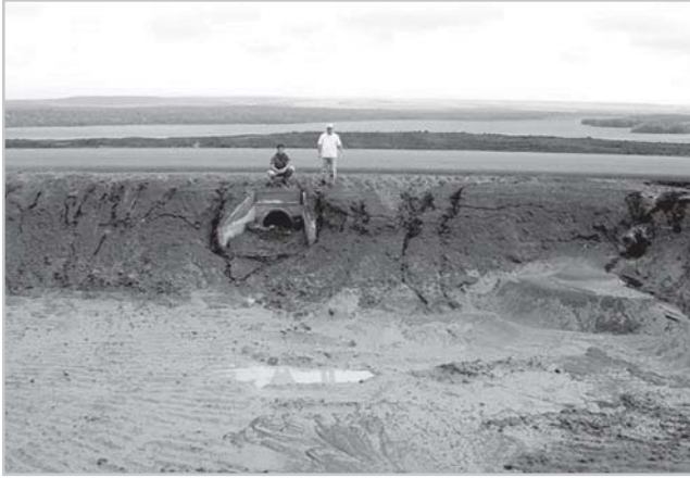
Vista de uma outra caixa de acumulação com profundidade de 2m de profundidade construída na Rodovia MT-235, com as marcas da absorção pelo lençol freático da água coletada, e o detalhe do desnível no lado de jusante.
