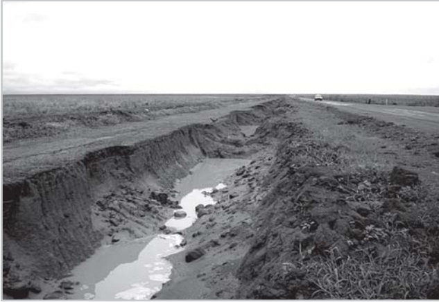
Vista de uma caixa de empréstimo lateral no lado de montante na MT-235, subtrecho Campo Novo do Parecis-Rio Papagaio, com detalhes do nível de acumulação e o empoçamento cerca de 6 horas após a precipitação.
