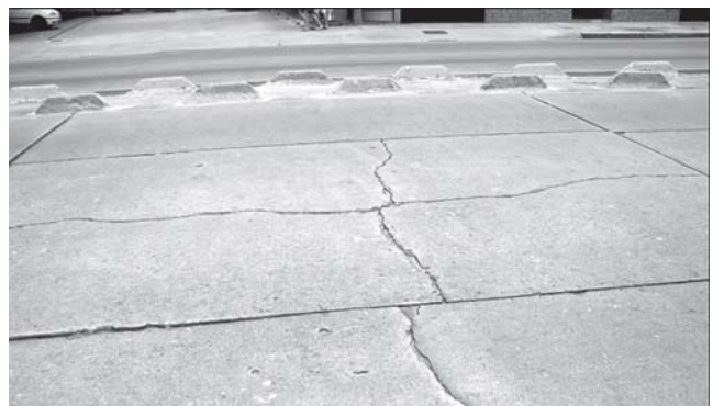
Figura 1 – Vista parcial do pavimento deteriorado da Av. Conde da Boa Vista
