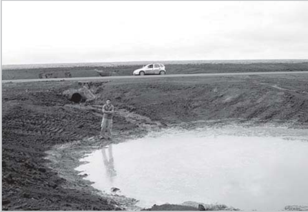
Vista da caixa de dispersão construída na rodovia MT-235, subtrecho Rio Papagaio-Sapezal, com detalhes das marcas da absorção do lençol freático que não permitiu o fluxo escoar pelos terrenos de jusante. Com esse procedimento a altura da plataforma da rodovia não precisa ser elevada para instalação do bueiro.
