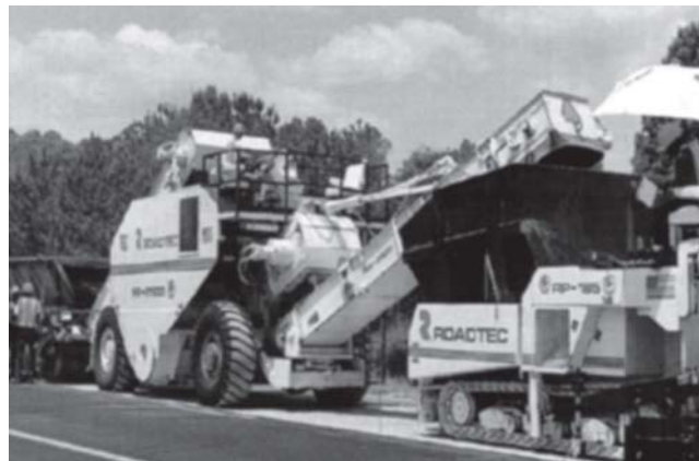
Figura 15 – Sistema de transferência de massa asfáltica para a acabadora. (FONTE: ASTEC - TP 134)
