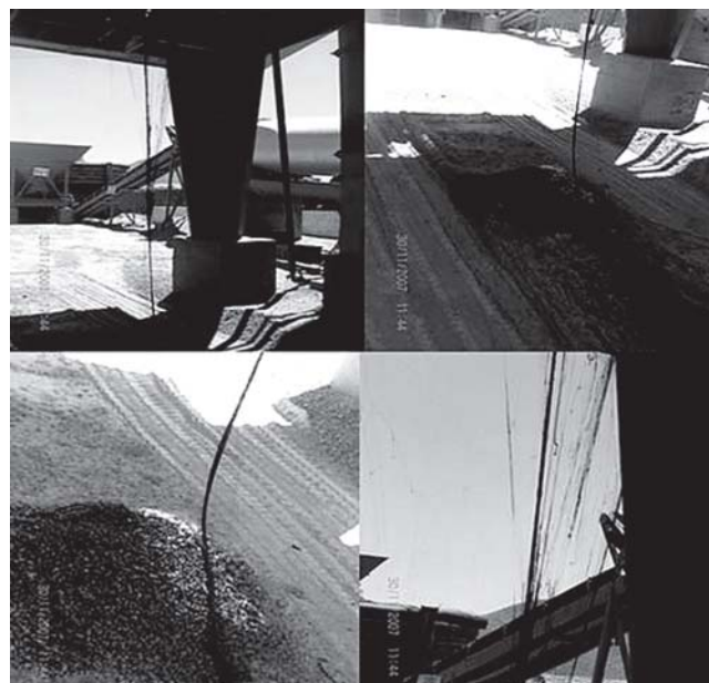
Figura 4 – Exemplos de falta de agitação no tanque de CAP (Fonte: J.M.Chaves)
