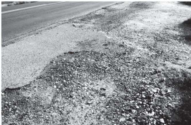
(a) Descontinuidade do revestimento
