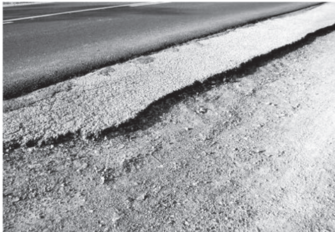
(b) inexistência de parte da estrutura
