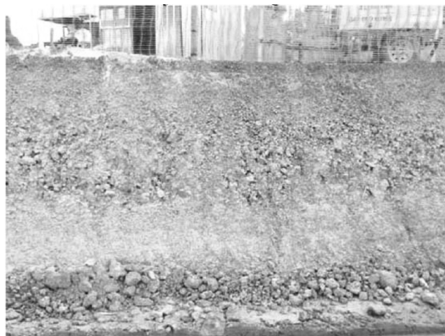
Figura 3 – Aspecto in situ de um solo laterítico com algumas concreções na região oeste do Maranhão (Der Osten et al., 2012).
