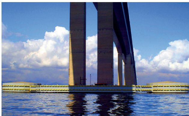
Sistema de proteção da ponte contra choques de navios.
