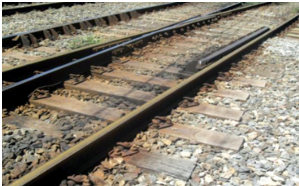
Figura 02 - Dormente polimérico aplicado em AMV, Região da Grade do Jacaré na ZM - 5 de Cavaleiro, CBTU/STU- Recife, 2006.
