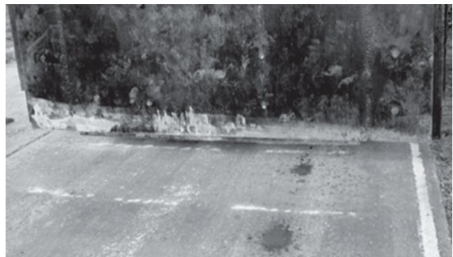
Figura 5 – Ilustração da irregularidade observada na seção transversal da placa, com concentração de tensão em alguns pontos.
