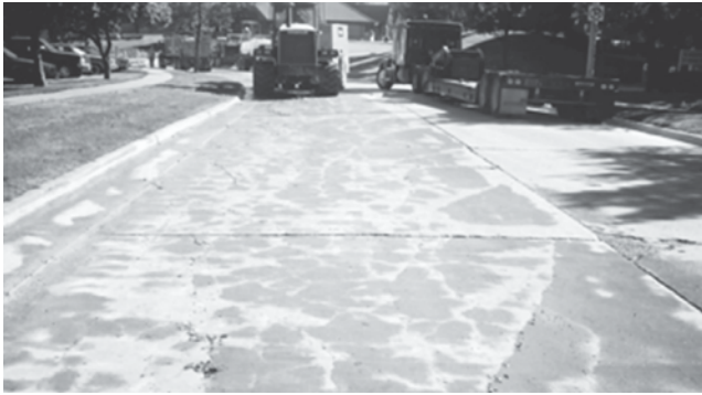
Figura 3 – Padrão de fissuramento com a metodologia crack and seat (Antigo Construction Inc.).
