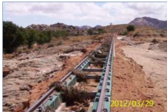
Fig. 9 – Danos provocados por pluviosidade excessiva (4.2)
