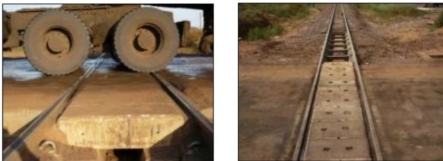
Fig. 10 – Passagem de nível implantada em Pan Station (África do Sul), no Corredor ferroviário de Maputo (4.3)
