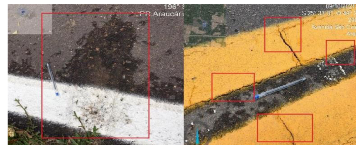
Figura 10: Patologias encontradas na superfície da pista Lado esquerdo) Painela; lado direito Fissuras Transversais e Horizontais Fonte: os autores (2021).
