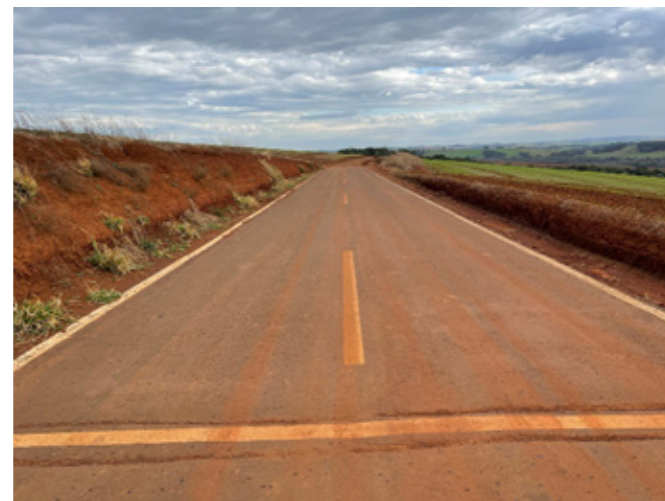
d) Base tratada com o produto e revestimento de CBUQ faixa “C”.
