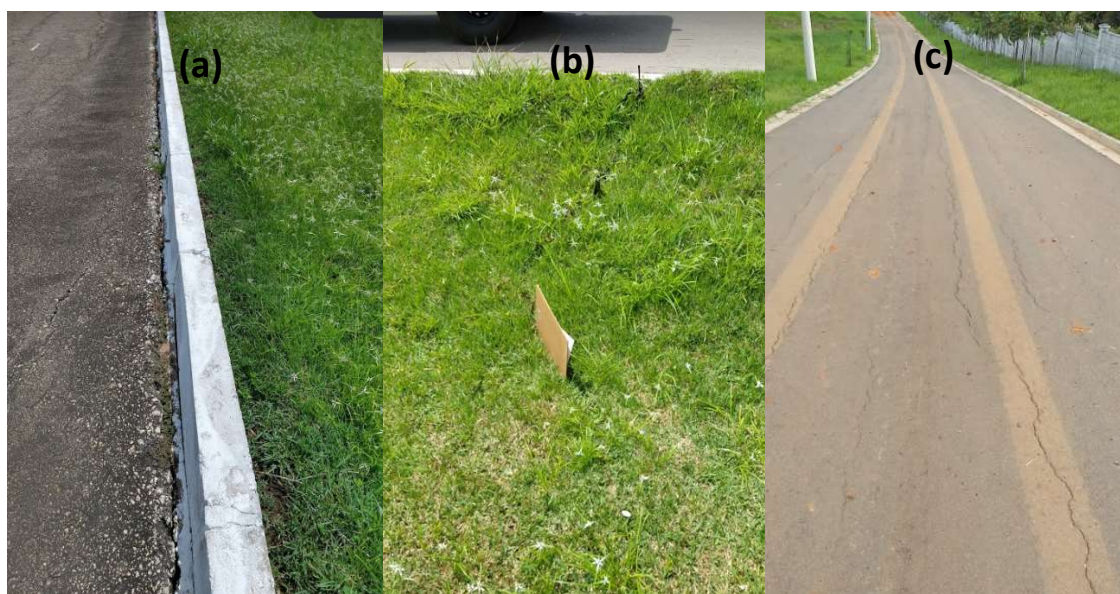
Figura 3: Defeitos em pavimentos locais decorrentes do subleito expansivo.
