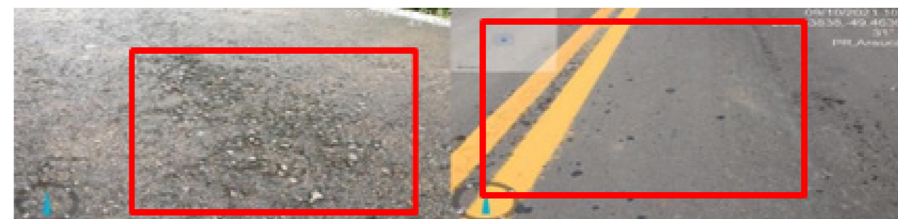
Figura 9: Patologias encontradas na superfície da pista / Lado esquerdo - desgaste; lado direito - exsudação Fonte: os autores (2021).
