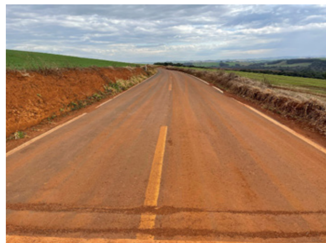
c) Base tratada com o produto e revestimento de CBUQ faixa “F”.
