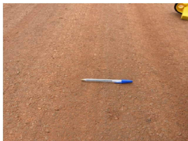
(a) Trinca transversal curta. Pista com revestimento CBUQ Faixa F.
